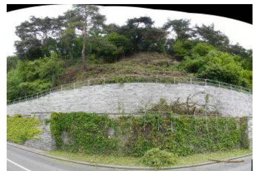
2016 entstandene, sekundäre Rutschung am Radweg bei Sipplingen
