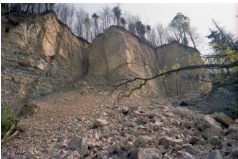
Abrisswand mit absitzender Scholle
