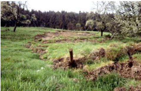
Rutschung im Opalinuston bei Göppingen
