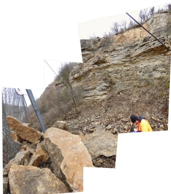
Prozessraum des Felssturzes von 2021
