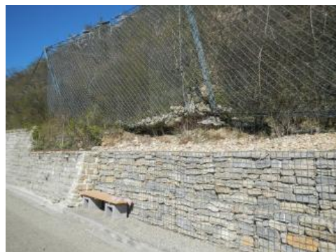
Steinschlagschutzzaun bergseitig des Wurmbergweges (Aufnahme 2014)
