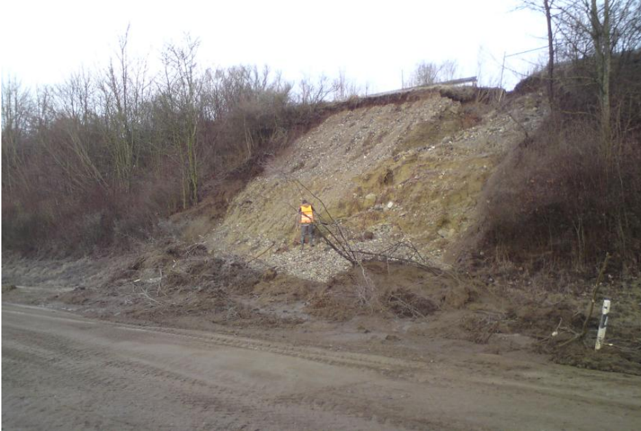
Abgerutschte Böschung an der A98 bei Orsingen-Nenzingen mit erosiv entstandener Rinnenstruktur im Bereich der Böschungskrone am Morgen des 24.01.2009
