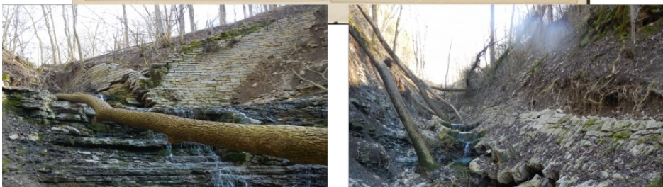
Intakter Tiroler Wildbachverbau von ca. 1903 im Vergleich zum zerstörten Erscheinungsbild nach dem Ereignis vom 29.05.2019 (Foto: Straßen- und Wasserbauamt, erhalten vom LRA Schwäbisch Hall)
