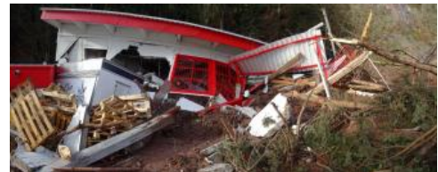
Durch den Murgang vollständig zerstörtes Nebengebäude
