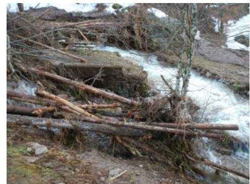
Verklausung und zerstörte Wirtschaftswegüberfahrt am Oberen Grobbach
