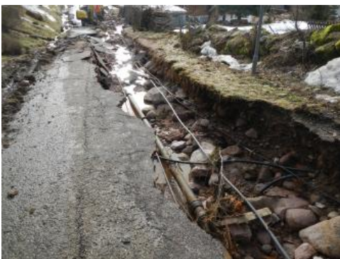
Charakteristische Erosionsschäden am Schwarzenbachweg
