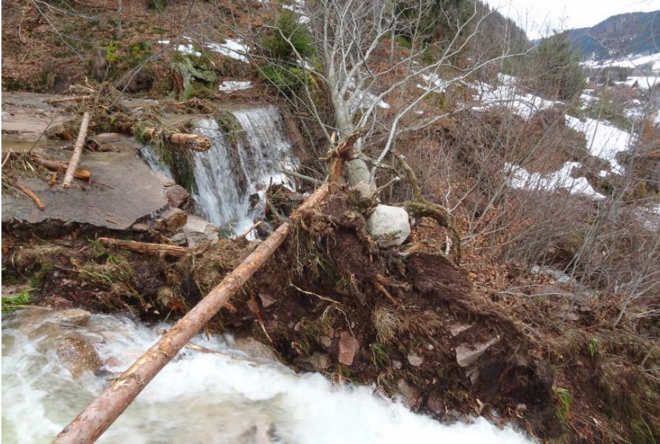
Baufälliges Wehr am Oberen Großbach
