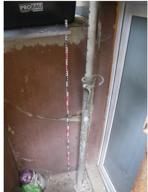
Gebäudeschäden an einem Kellerabgang
