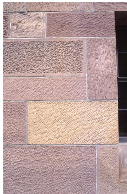
Mauerwerk aus Maulbronner Sandstein an der Domkirche St. Eberhard in Stuttgart
