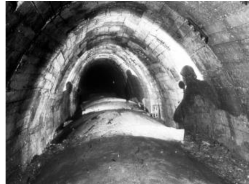
Sohlhebungen im Wagenburgtunnel infolge Anhydritschwellens der Grabfeld-Formation
