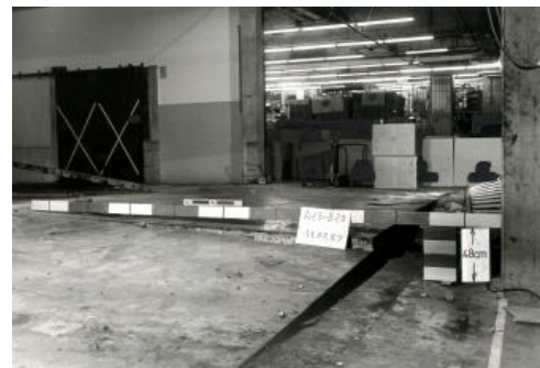
Aufwölbung des Untergrunds
