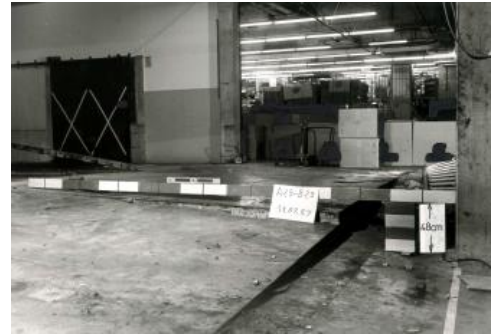
Aufwölbung des Untergrunds
