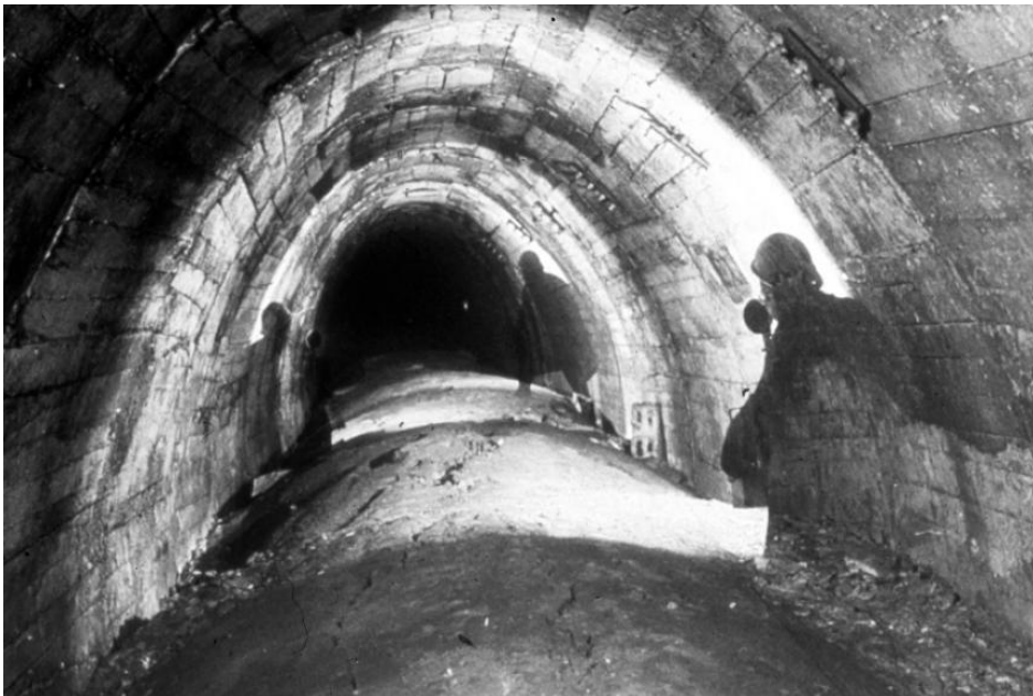
Sohlhebungen im Wagenburgtunnel infolge Anhydritschwellens der Grabfeld-Formation
