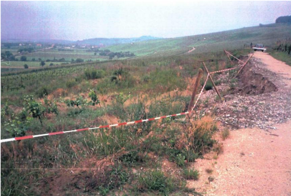
Blick auf eine Rutschung talseits des Wirtschaftsweges im Gewinn „Benz“ (Foto: Ingenieurbüro Ertel & Partner, Müllheim)
