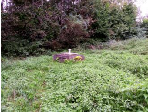
Quellschacht der Jägertalquelle 5, Anselmingen
