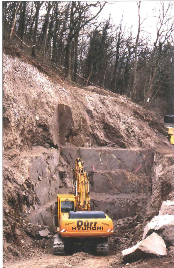
Abb. 14: Ende des viersöchigen Abbaus im März 2004 am Schlossberg bei Achkarren, Beginn der Wiederverfüllung. Erkennbar ist der hellere, regellos brechende Tephrit der 3–4 m tiefen Aufwitterungszone.
